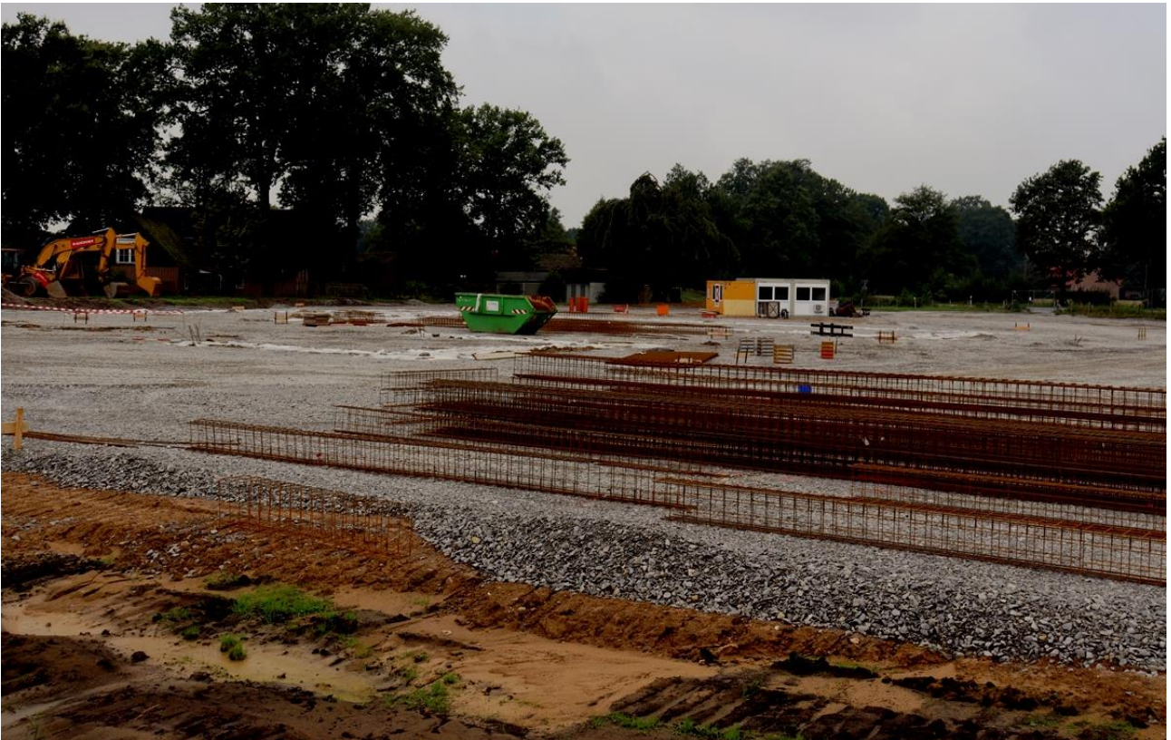
Blick auf einen Teil der Baustelle für die geplante Reitsportanlage. Erkennbar der massive Eingriff in die Landschaft mit großflächiger Versiegelung. Fotos: BUND
