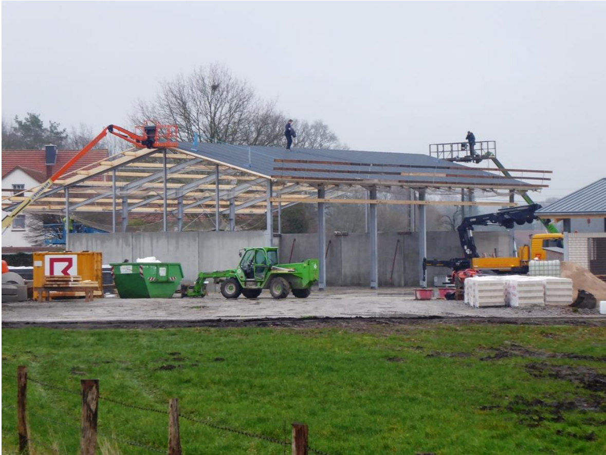
15.12.2021, ca. 12:00 Uhr: Arbeiten am Dach der Bergehalle. Am Vortag waren hier erst einige Dachbalken montiert. Mit notwendiger „Sicherheit“ der Baustelle hat das nichts zu tun.
