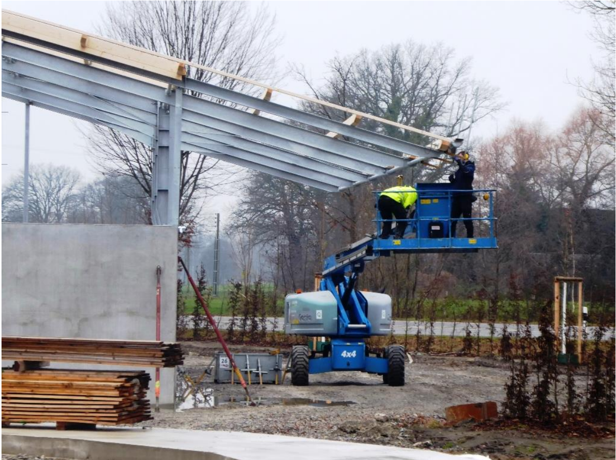
14.12.2021, ca. 14:00 Uhr: Montage von Dachbalken für das Dach der Bergehalle (mit diesen Arbeitern wurde ein Gespräch geführt. Ihnen war von einem Baustopp nichts bekannt)
